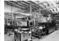
Baffeln aus Steinwolle-Akustikplatten in einer Getränkefirma (Abfüllanlage).
